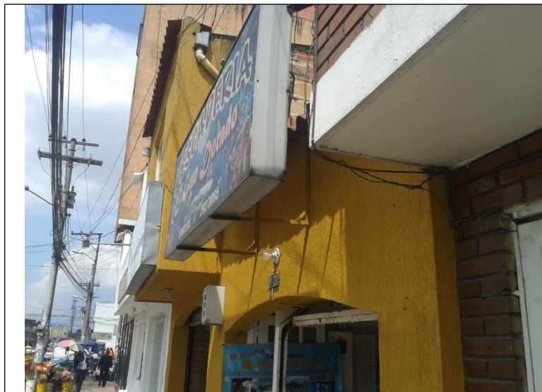
Fotografía No. 2: Aviso Publicitario del establecimiento ubicado en la Carrera 78 No. 8B-29. El aviso esta volado de la fachada.
